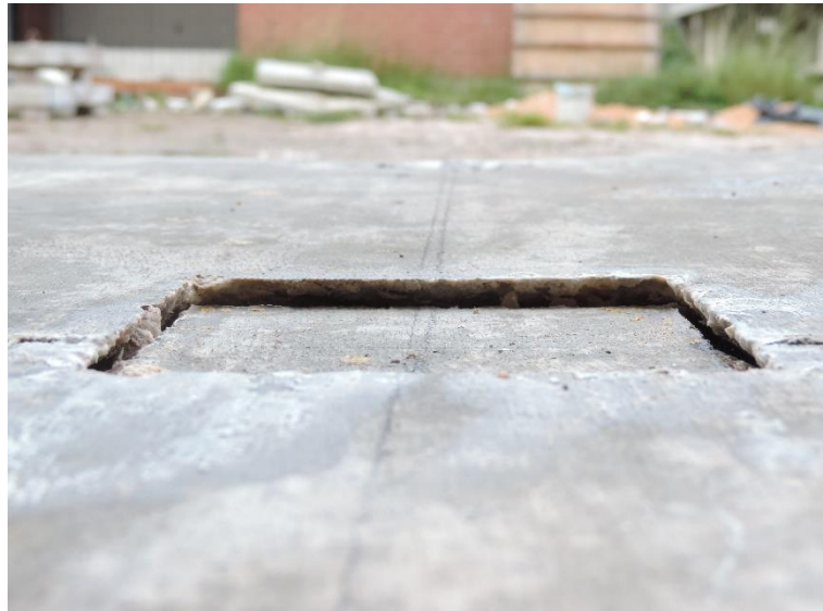
Figura 6.31 – Penetração da chapa na face inferior da laje
